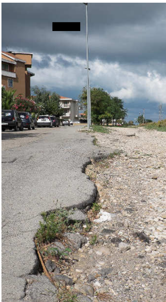
Scheda 25- Fotografia n° 4 TERMINE DI CARREGGIATA NON DELINEATO
