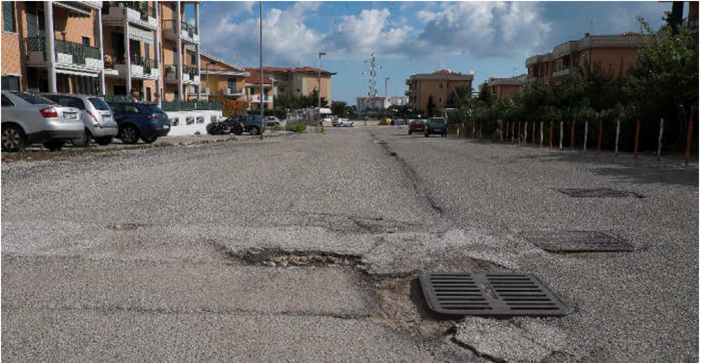
Scheda 2 - Fotografia n° 1 - STATO DELL'ASFALTO
