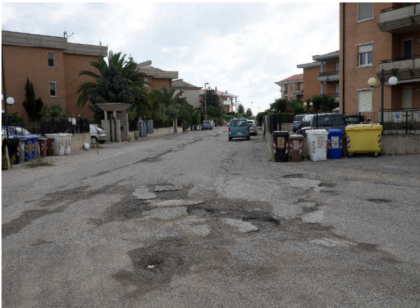
Scheda 15 - Fotografia n° 1 STATO DELL'ASFALTO
