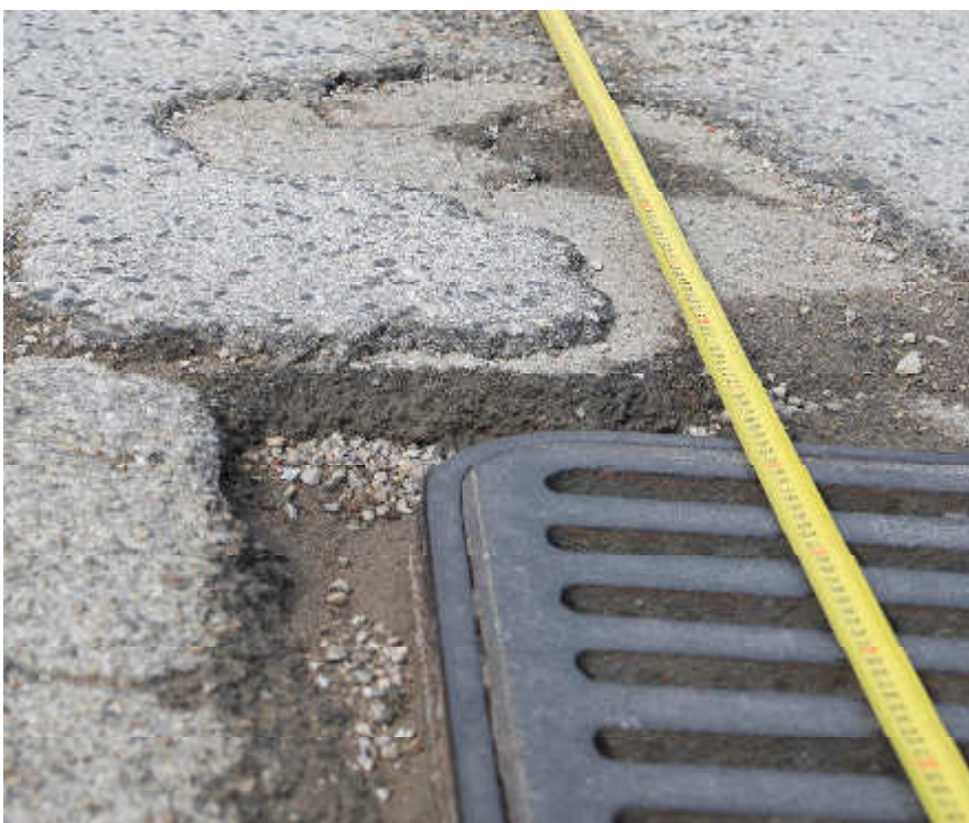
Fotografia n° 4 MISURAZIONE INSIDIA STRADALE
