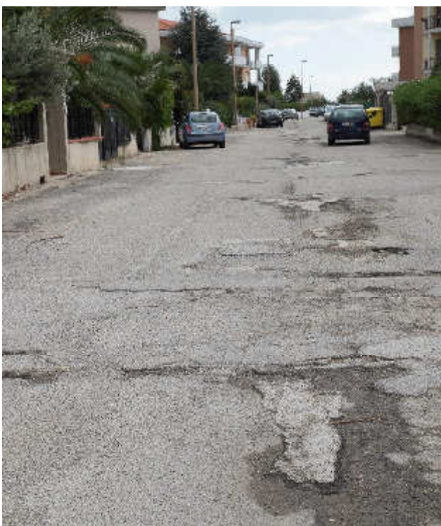
Scheda 16 - Fotografia n° 2 STATO DELL'ASFALTO
