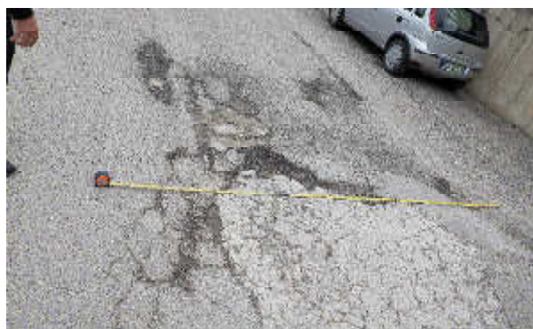
Fotografia n° 3 MISURAZIONE INSIDIA STRADALE
