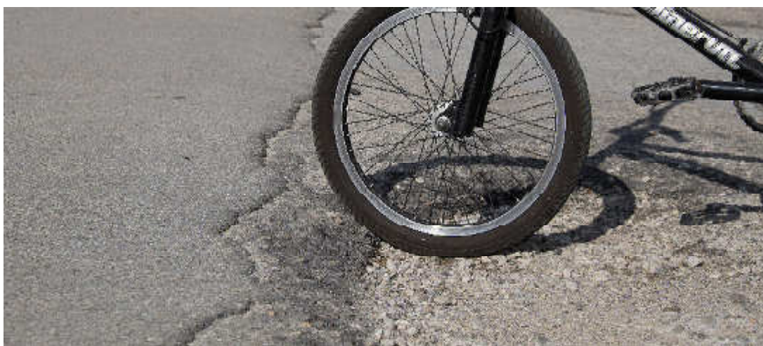
Scheda 1 - Fotografia n° 3 - ESEMPIO SITUAZIONE DI PERICOLO
