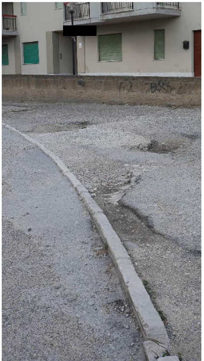
Scheda 24- Fotografia n° 4 STATO DELL'ASFALTO
