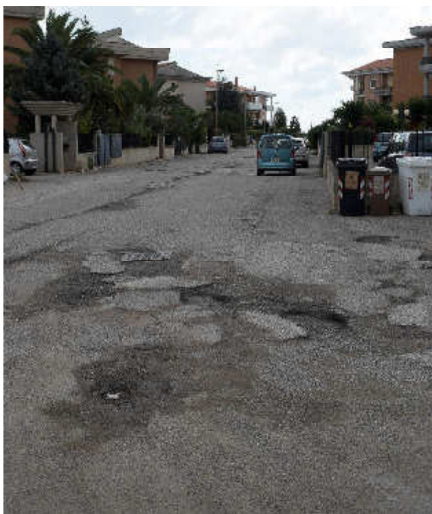
Scheda 15 - Fotografia n° 2 STATO DELL'ASFALTO
