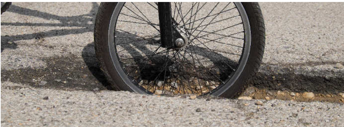
Scheda 5 - Fotografia n° 5 - ESEMPIO SITUAZIONE DI PERICOLO
