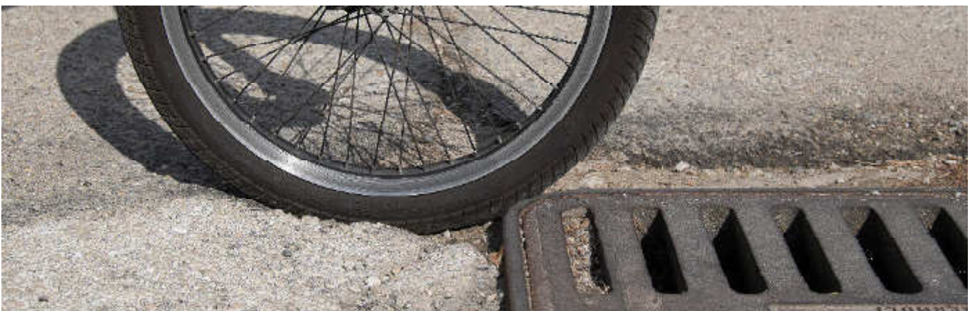
Scheda 2 - Fotografia n° 5 - ESEMPIO SITUAZIONE DI PERICOLO
