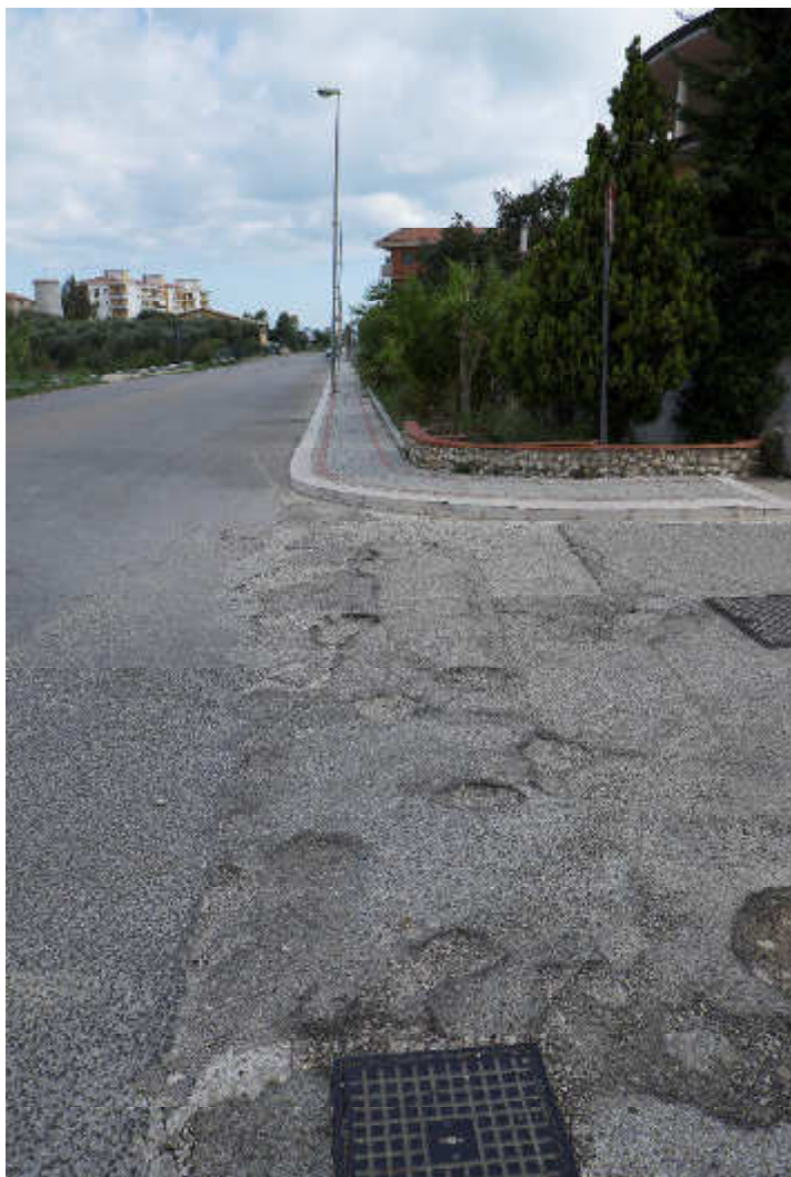
Fotografia n° 1 - STATO DELL'ASFALTO DIREZIONE LUNGOMARE
