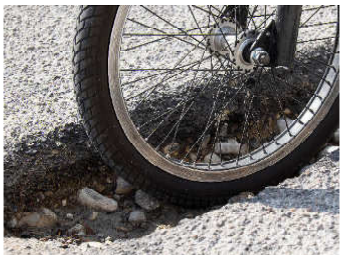
Scheda 3 - Fotografia n° 5 - ESEMPIO SITUAZIONE DI PERICOLO
