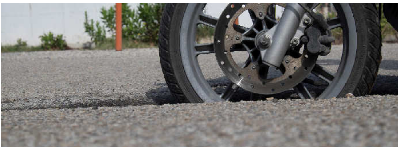
Scheda 5 - Fotografia n° 4 - ESEMPIO SITUAZIONE DI PERICOLO
