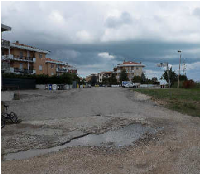
Scheda 24- Fotografia n° 1 STATO DELL'ASFALTO
