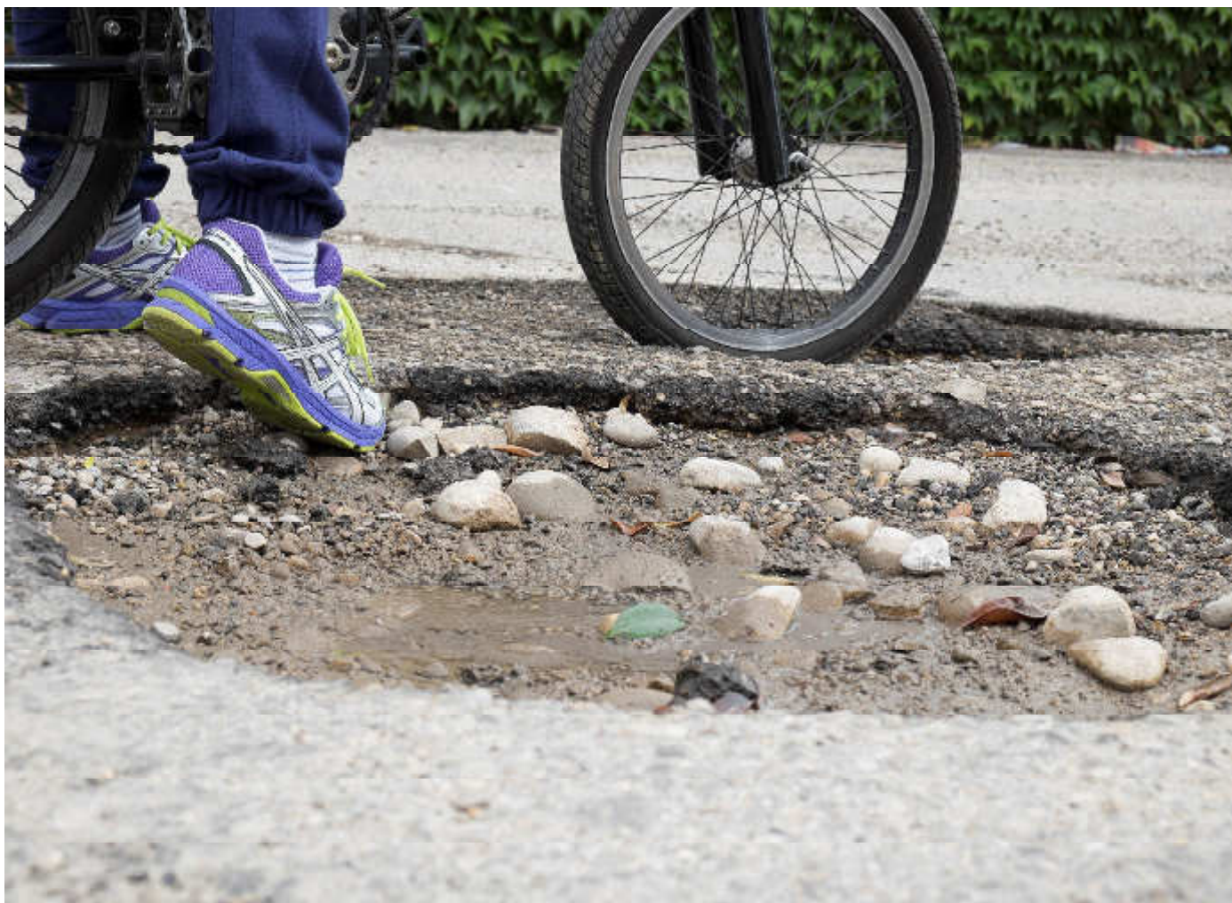
Scheda 18 - Fotografia n° 1 ESEMPIO SITUAZIONE DI PERICOLO
