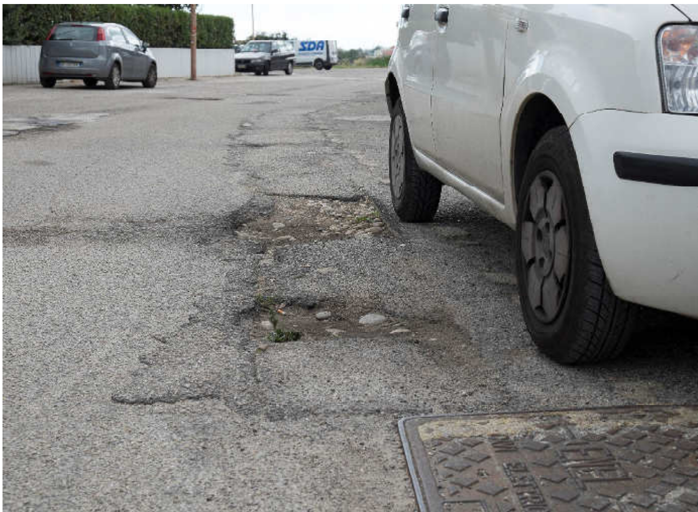
Scheda 20 - Fotografia n° 1 STATO DELL'ASFALTO
