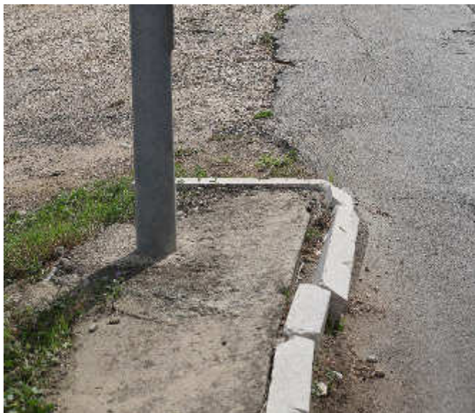
Scheda 25- Fotografia n° 2 PAVIMENTAZIONE SCONNESSA
