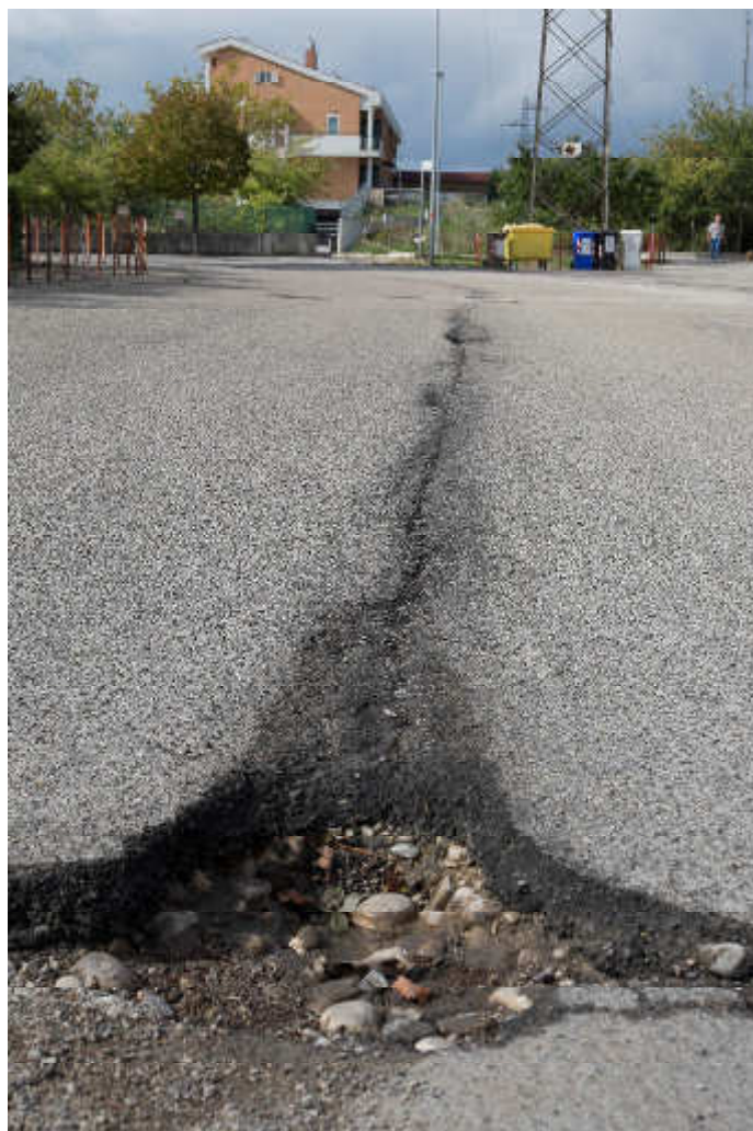
Scheda 4 - Fotografia n° 5 - PARTICOLARE SULLO STATO DELL'ASFALTO
