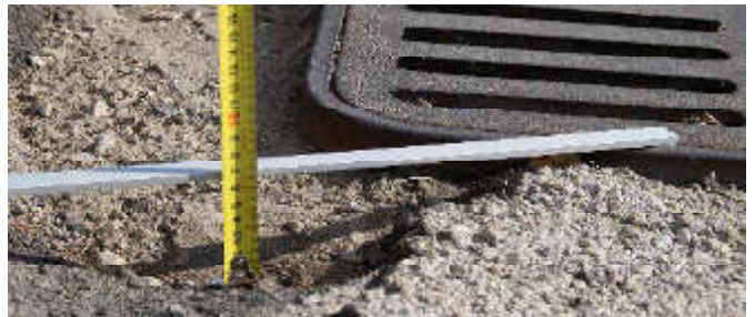
Scheda 2 - Fotografia n° 3 - MISURAZIONE PROFONDITA' DELLA BUCA
