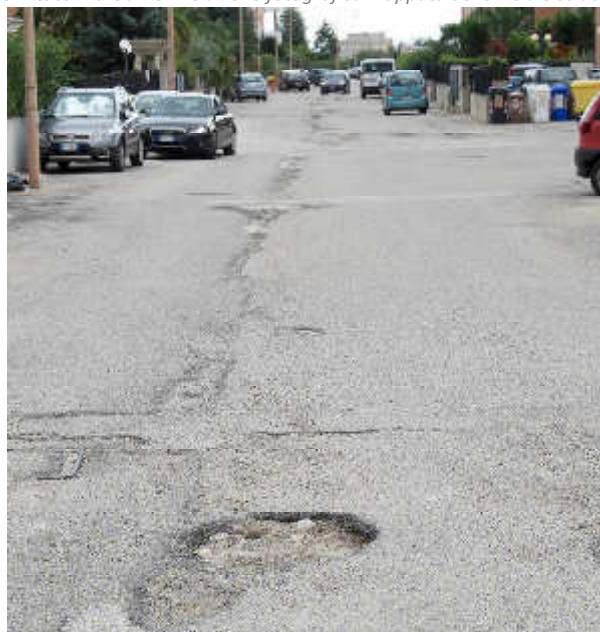
Fotografia n° 2 BUCA AL CENTRO DELLA STRADA
