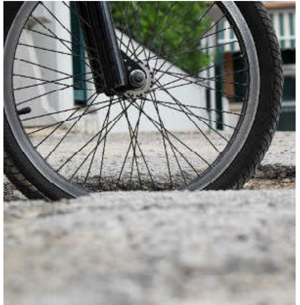
Fotografia n° 2 ESEMPIO SITUAZIONE DI PERICOLO
