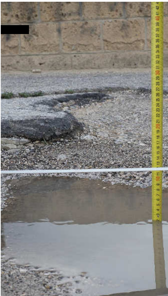
Scheda 24- Fotografia n° 3 MISURAZIONE PROFONDITA' DELLA BUCA SISTEMATICAMENTE ALLAGATA E POCO VISIBILE DOPO LE PIOGGIE
