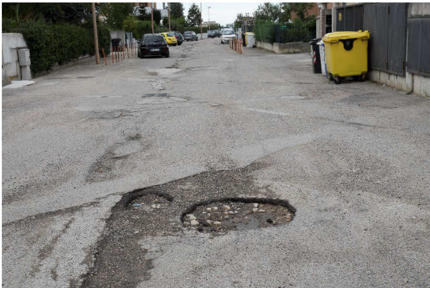
Scheda 17 - Fotografia n° 1 STATO DELL'ASFALTO
