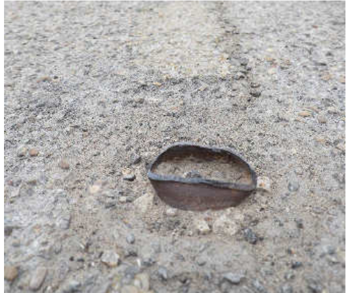
Scheda 23- Fotografia n° 1 STATO DELL'AFALTO CON RESTI DEI PALI IN METALLO SPORGENTI IN SUPERFICE ALLA STRADA
