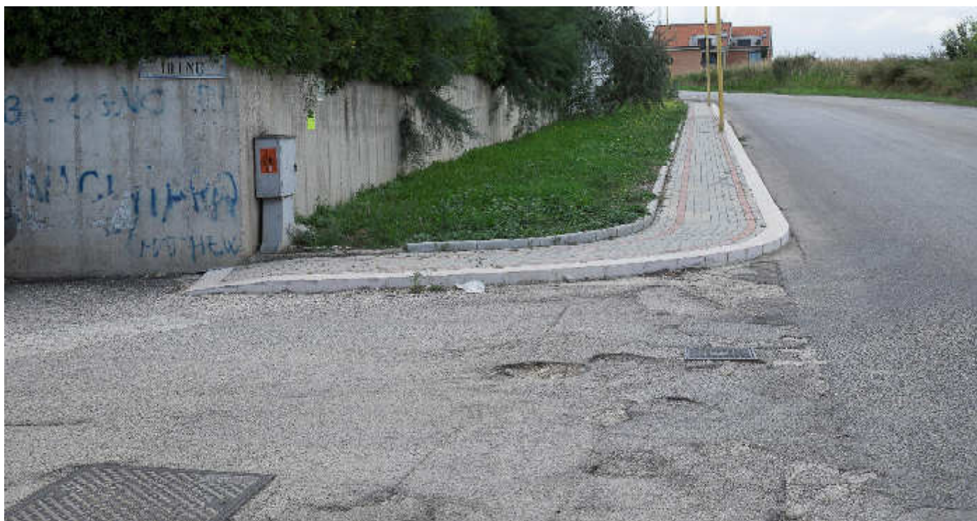
Fotografia n° 3 - STATO DELL'ASFALTO DIREZIONE VIA FIRENZE
