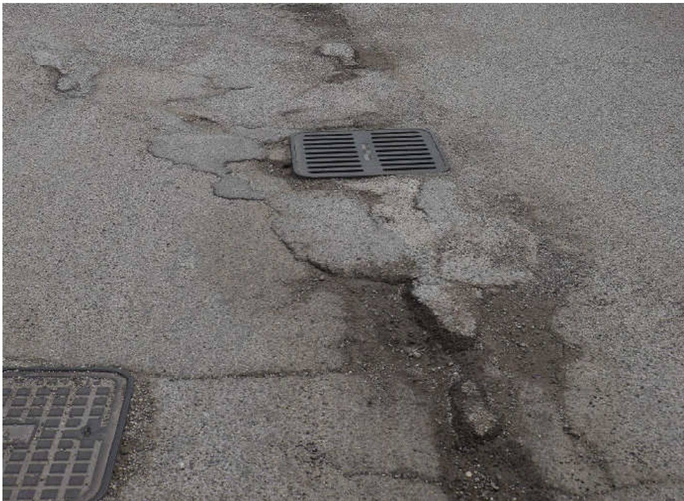
Scheda 16 - Fotografia n° 1 STATO DELL'ASFALTO
