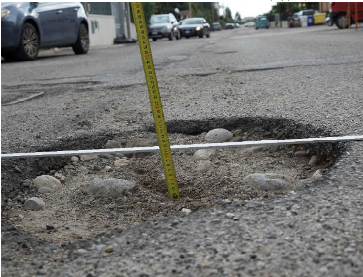
Fotografia n° 1 MISURAZIONE PROFONDITA' DELLA BUCA
