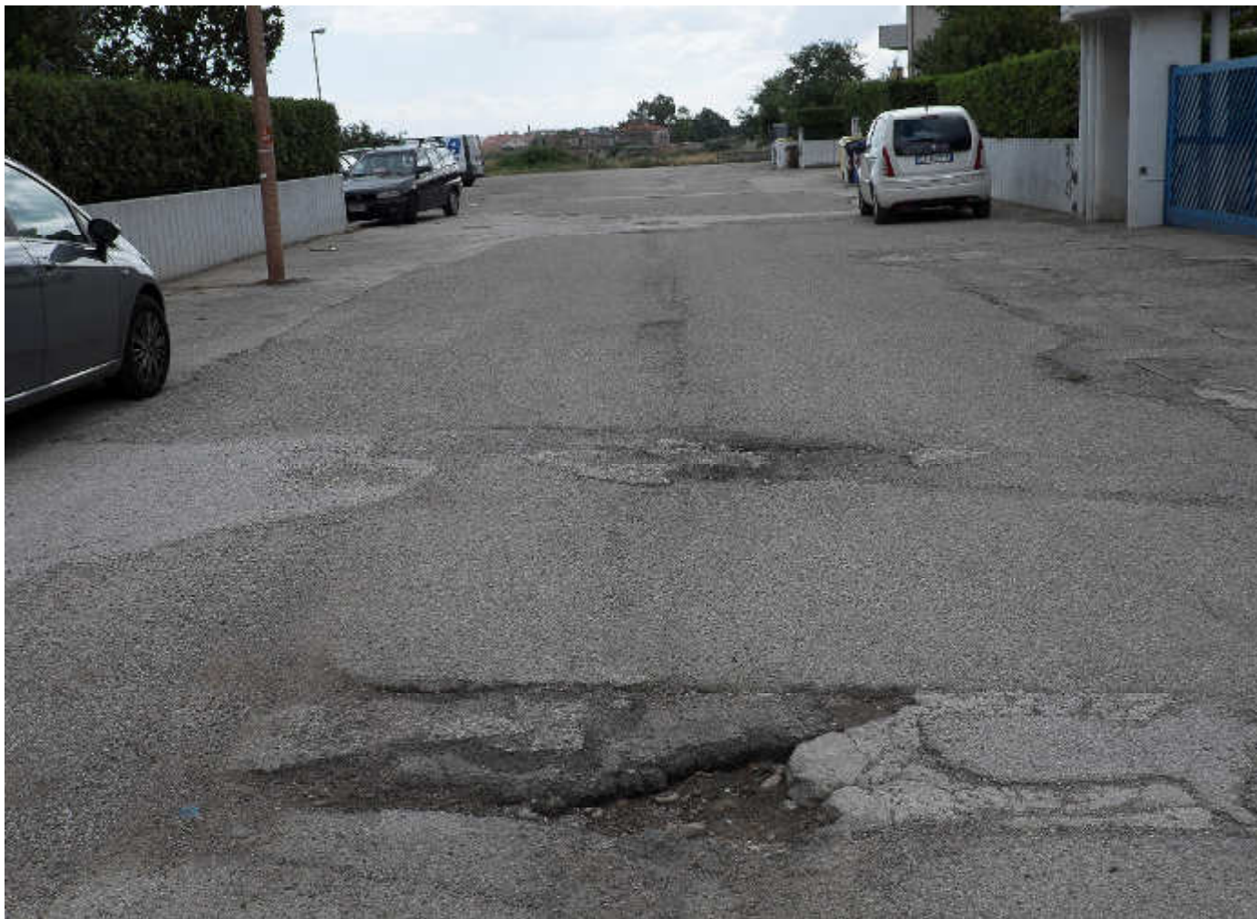
Scheda 21 - Fotografia n° 1 STATO DELL'ASFALTO
