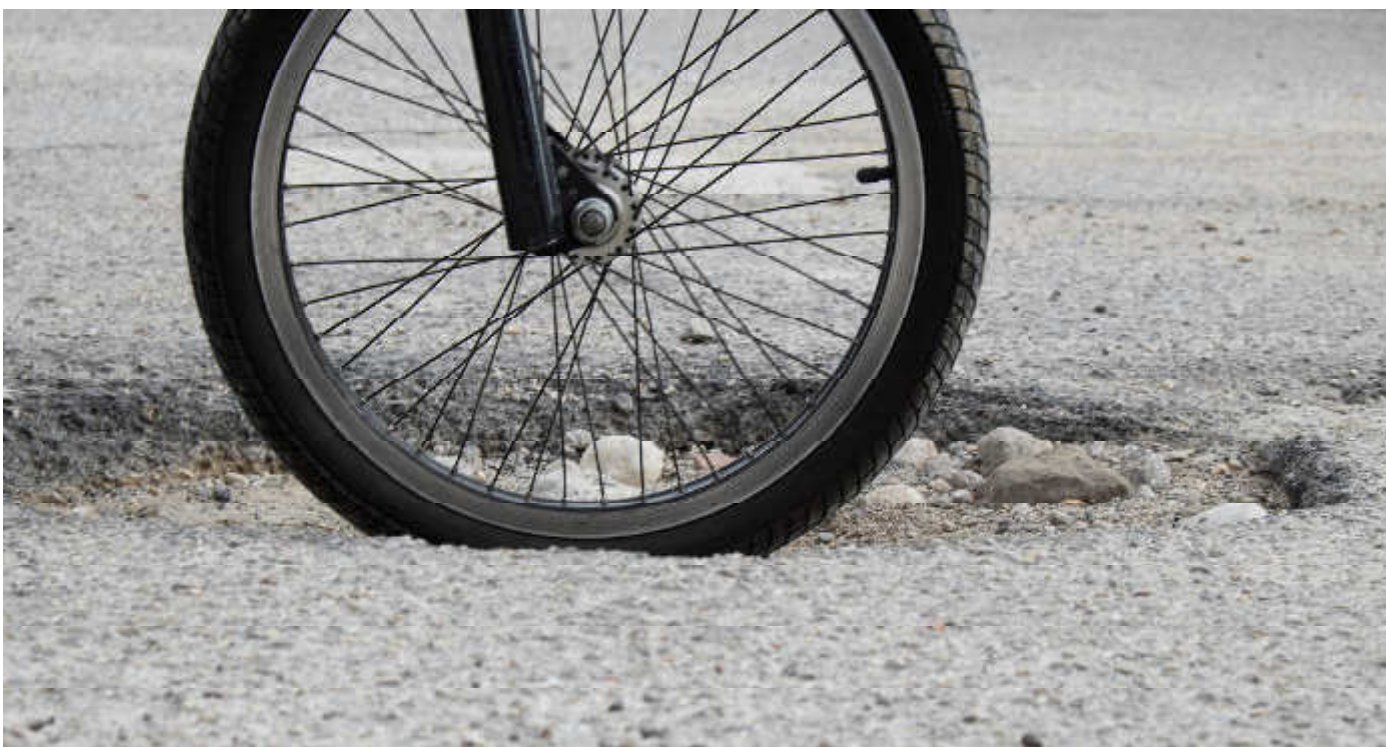
Fotografia n° 2 ESEMPIO SITUAZIONE DI PERICOLO
