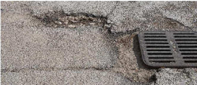
Scheda 2 - Fotografia n° 2 - STATO DELL'ASFALTO
