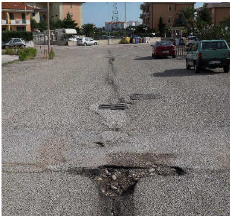
Scheda 4 - Fotografia n° 1 - STATO DELL'ASFALTO
