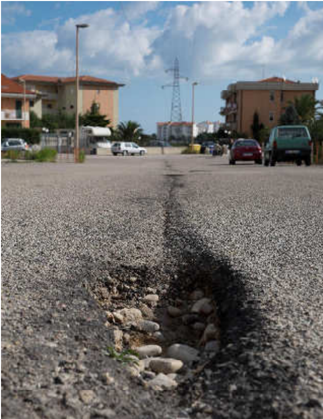
Scheda 3 - Fotografia n° 1 - STATO DELL'ASFALTO
