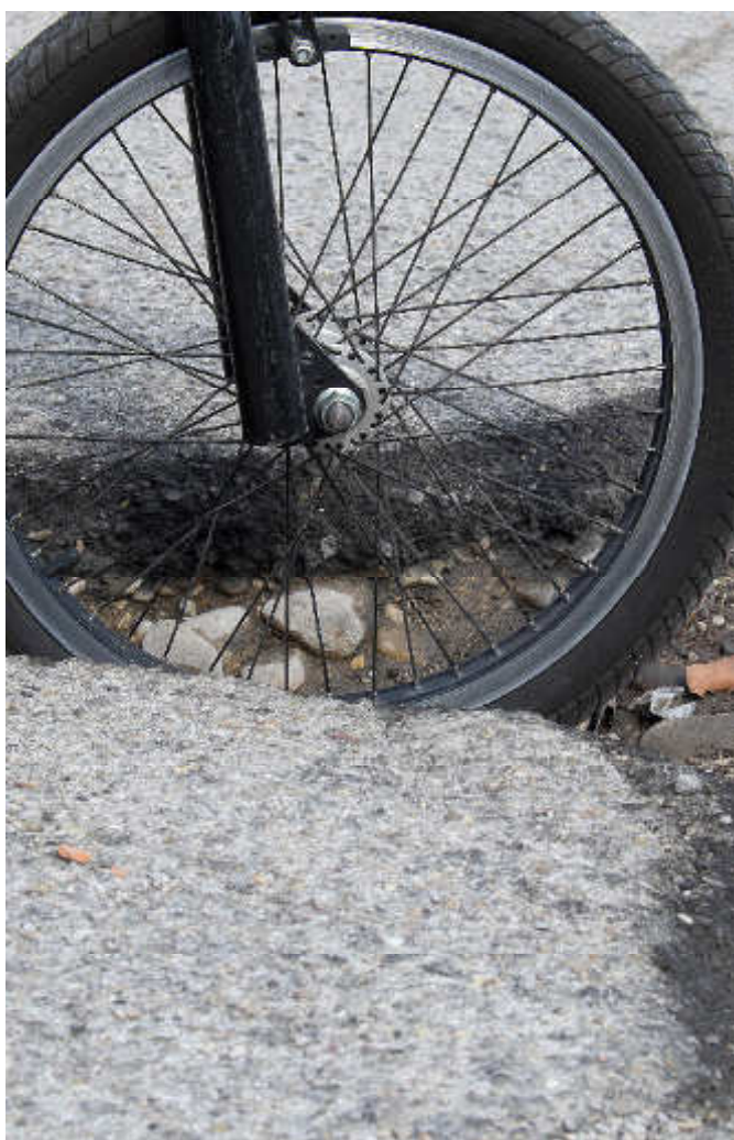
Scheda 4 - Fotografia n° 3 - ESEMPIO SITUAZIONE DI PERICOLO
